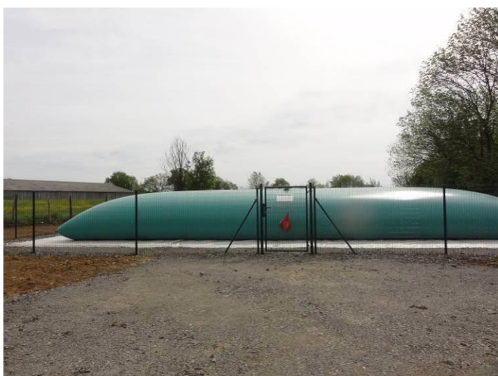
Réserve d'eau pour lutter contre les incendies (Source : INGEROP)
