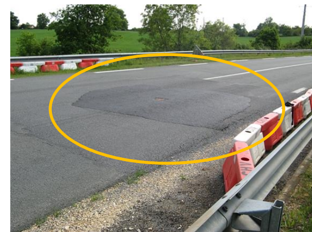
Zone remblayée suite à un effondrement sur RD 83 le 20/04/2009
